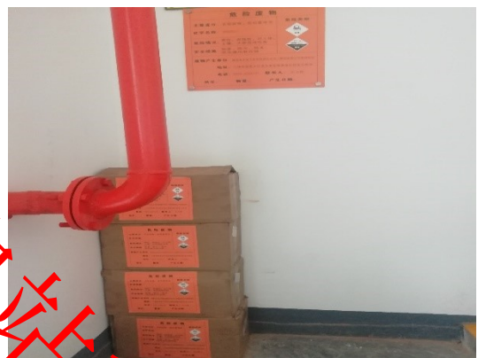
图 6-4 危废暂存间内分区—废蓄电池区
